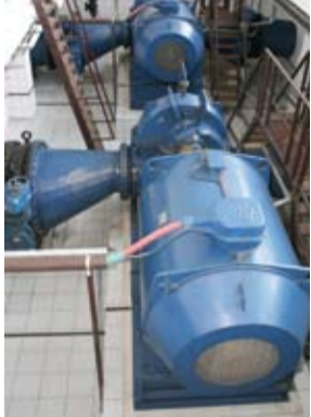
Pompele de la Stația de tratare Bega furnizează două treimi din apa Timișoarei
