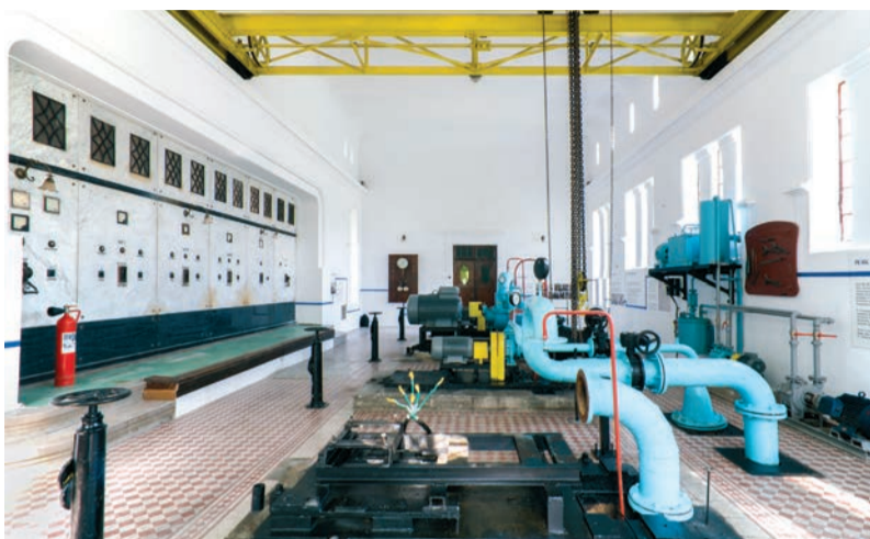
Sala mașinilor de la Uzina veche de Apă Industrială din Timișoara, o adevărată „capsulă în timp”. Foto: Mircea Pap
